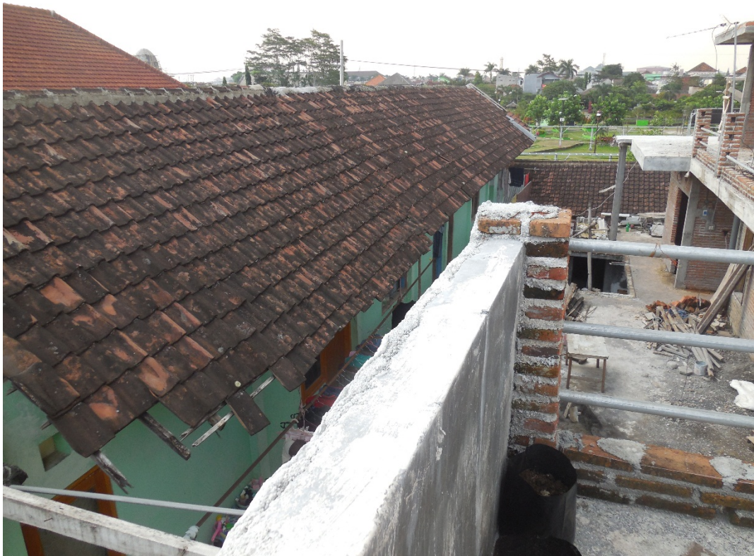
Atap asrama sisi kiri yang akan diperbaiki
